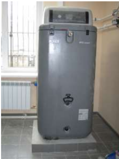
Тепловой насос. Внутренний блок
